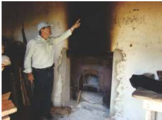
Secador com vazamento de fumaça
