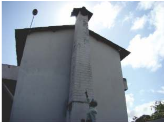
Secador com chaminé corretamente instalada acima da cumeeira
